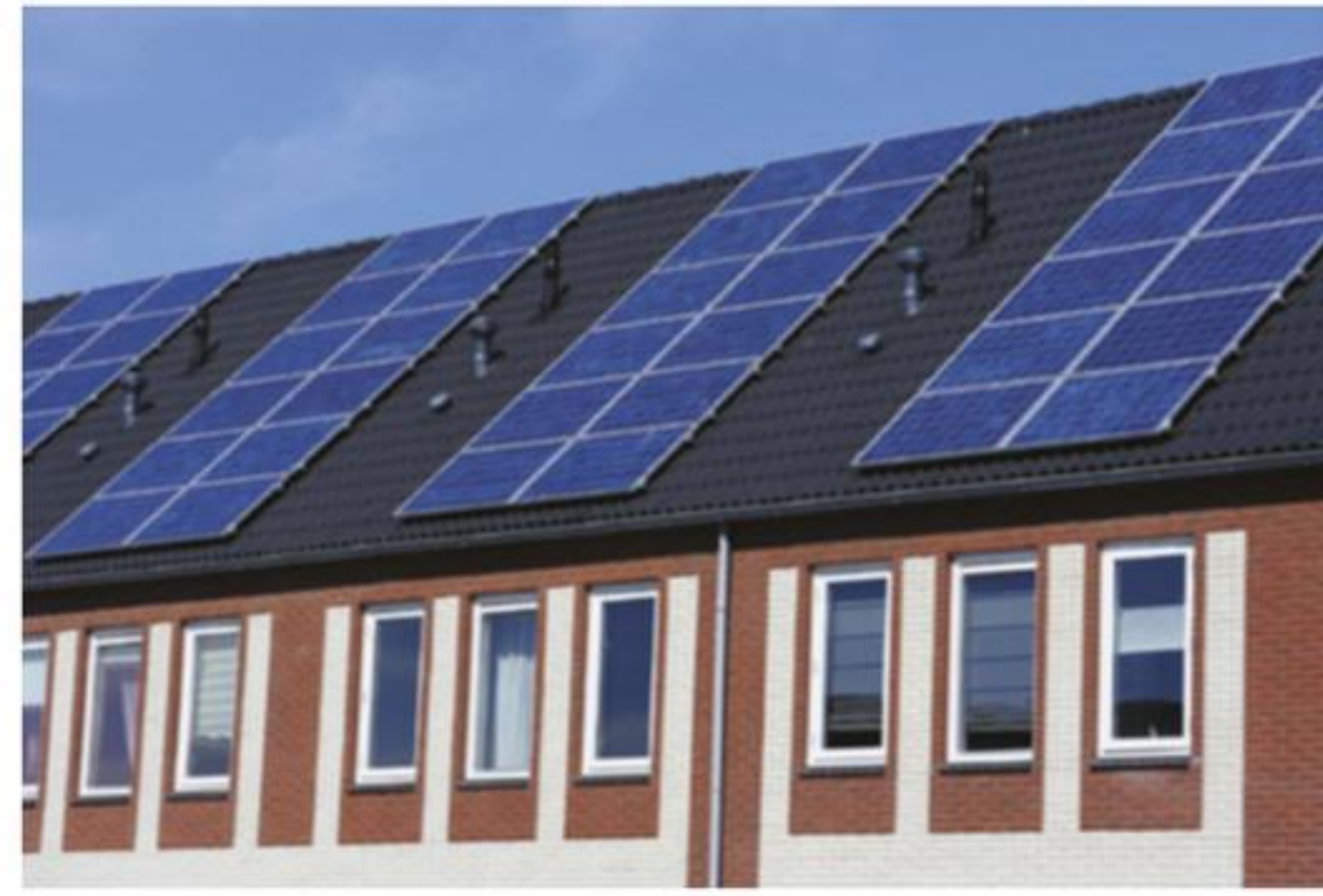
2 zonnepanelen om elektriciteit mee op te wekken
