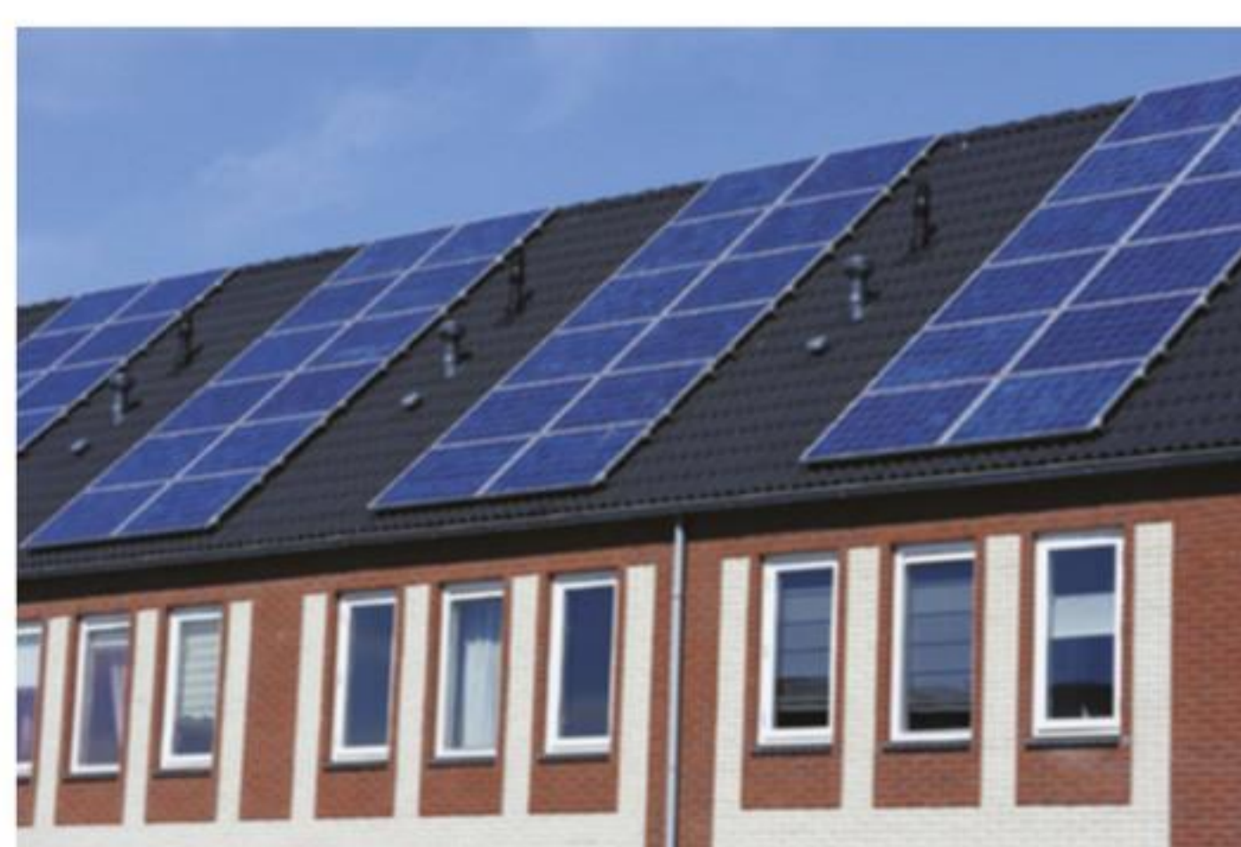
2 zonnepanelen om elektriciteit op te wekken
