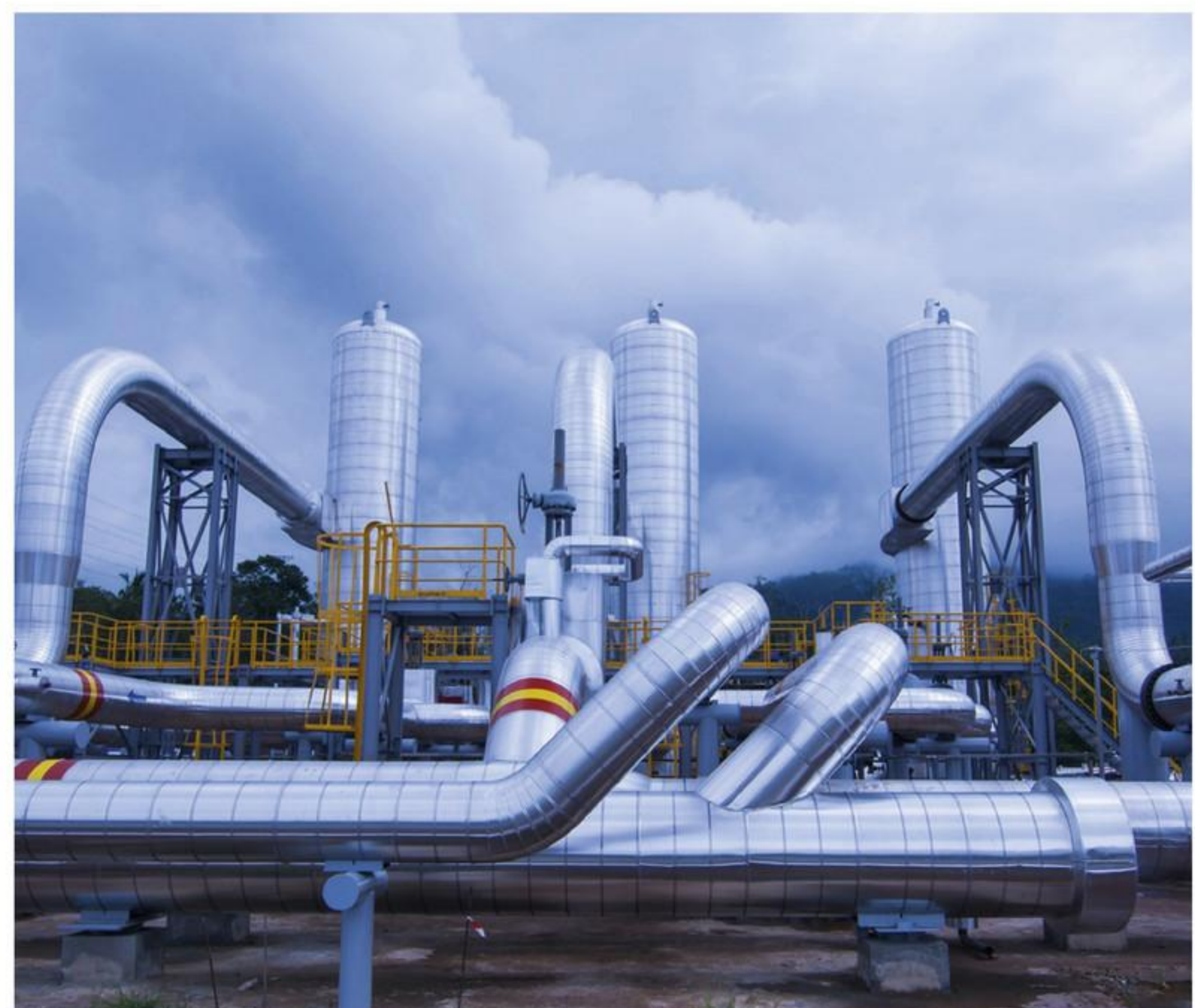
■ Afb. 39 Geothermische elektriciteitscentrale op Sumatra, Indonesië.
