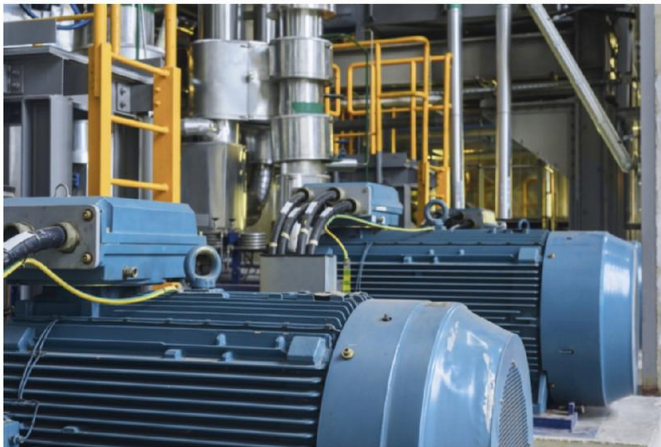
afbeelding 3 In een elektriciteitscentrale staan heel grote generatoren.
