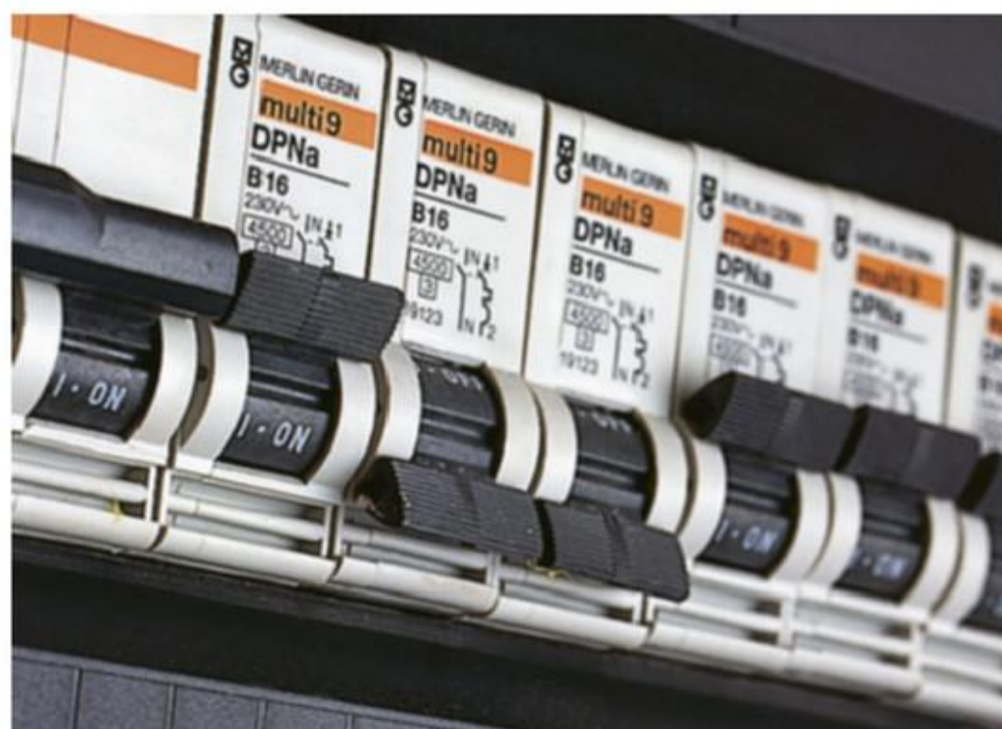
afbeelding 12 Installatie-automaten in de meterkast.
