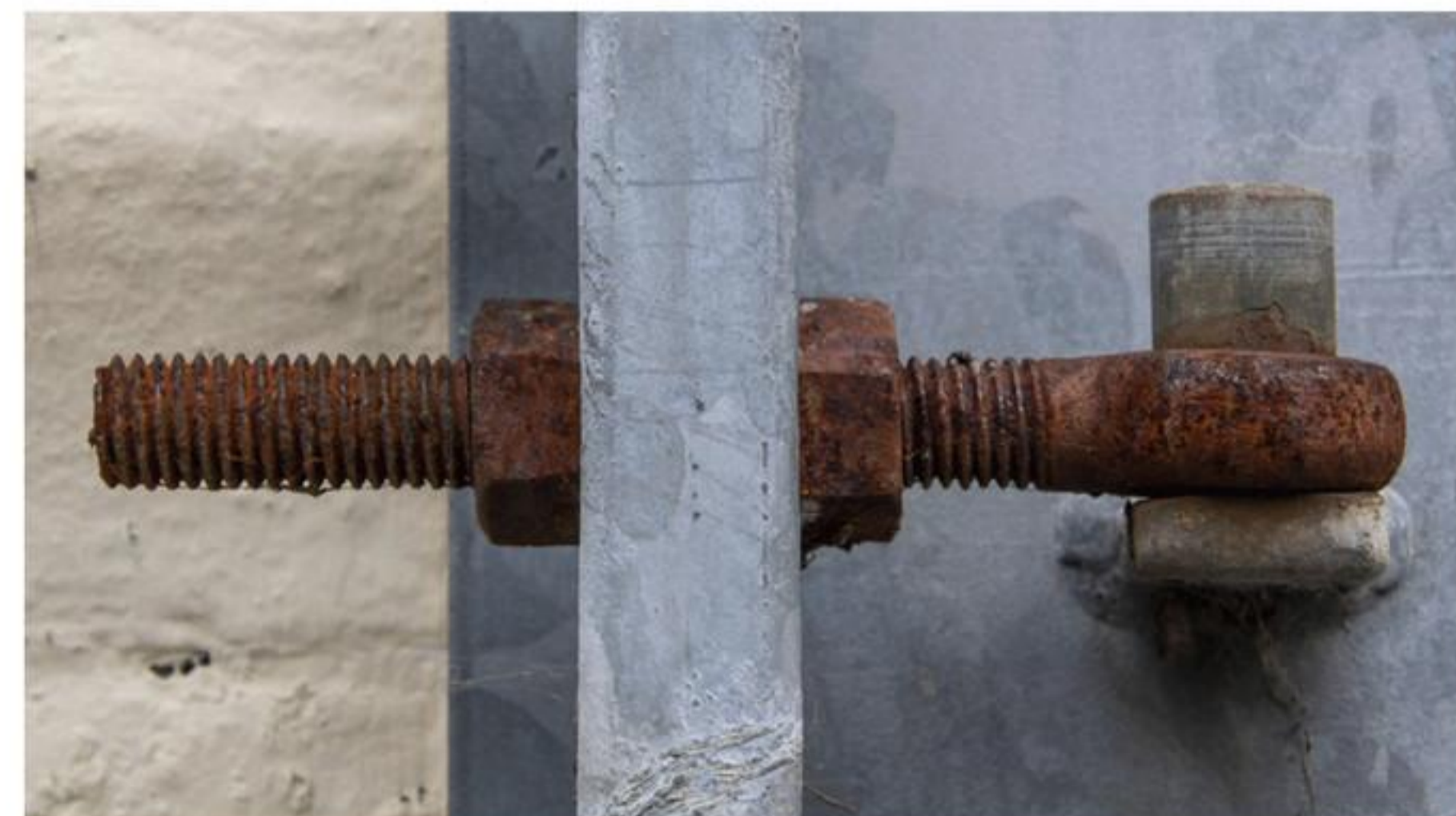
afbeelding 10 De bout en de moeren zijn niet verzinkt. De stalen plaat is wel verzinkt.
