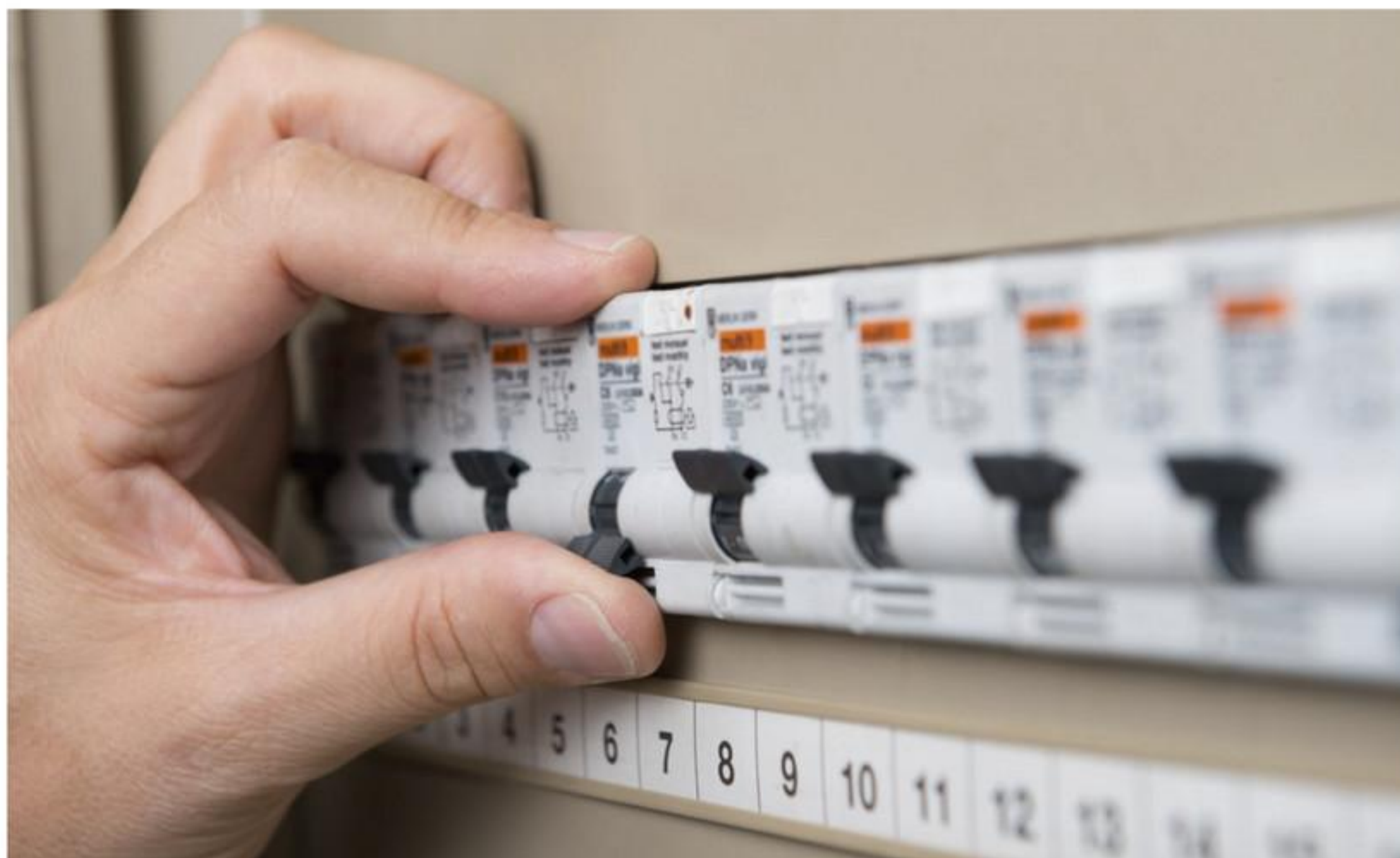
afbeelding 2 Een groepenkast met een uitgeschakelde groep.
