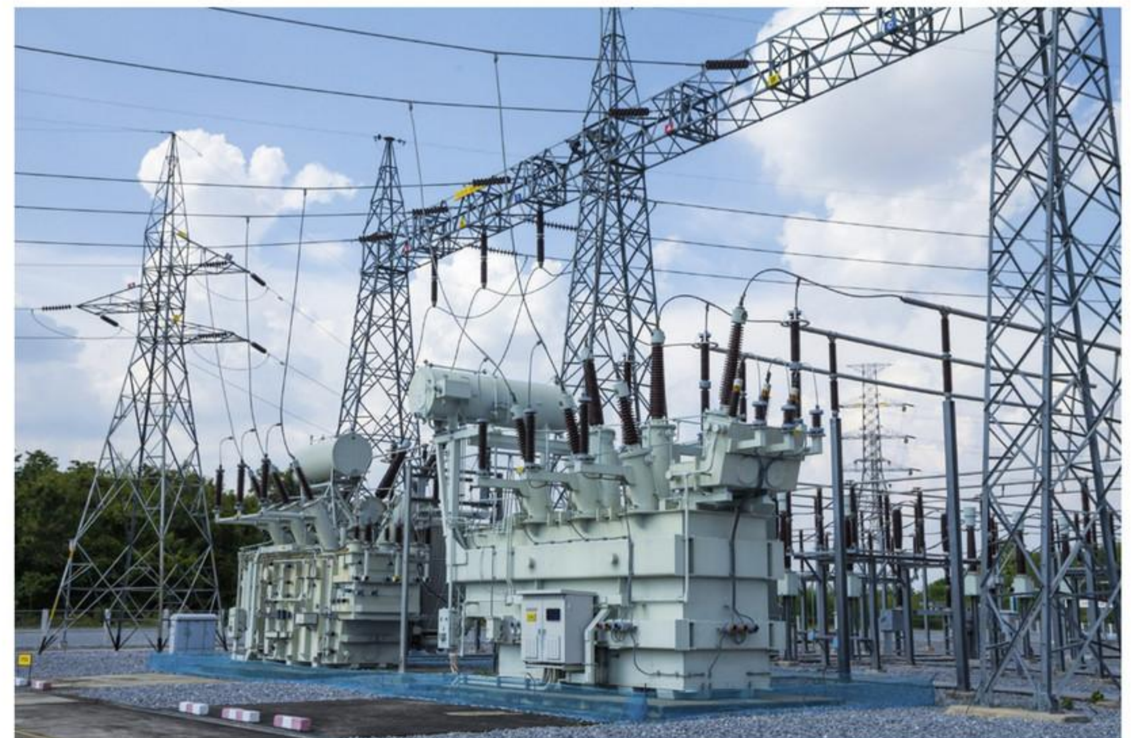
afbeelding 10 Twee transformatoren die de spanning vergroten.
